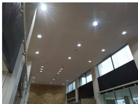
江東区総合区民センター ロビー照明
